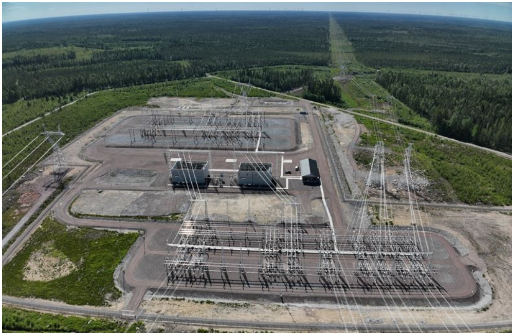
Kuva Pyhäjoen Valkeuden 400/100 kV sähköasemasta
